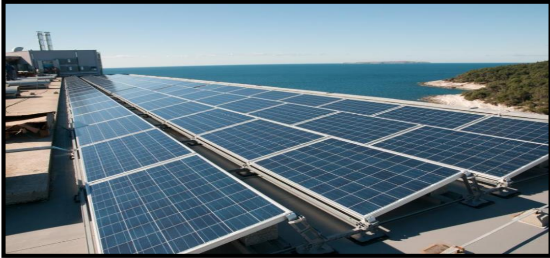
Slika 4. Krovni solarni sustavi na otoku Lošinju
