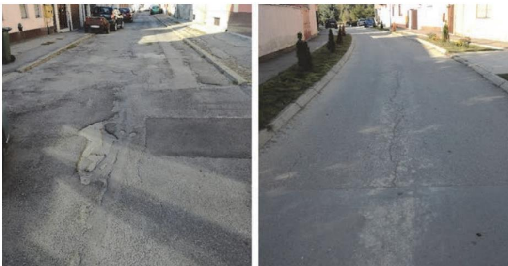
Slika 8: Fotografije postojećeg stanja kolnika: a) Cvjetkova ulica, b) Lađarska ulica, (Zagvozda, Dimiter, Moser, Barišić, 2019., 303. str.)
