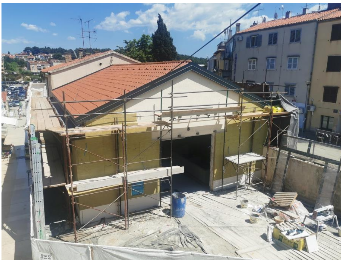
Slika 4. Preuređenje ribarnice Poreč
