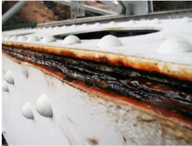
Slika 5: Procijepna korozija konstrukcije mosta [11]
