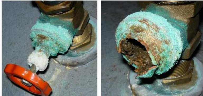
Slika 7: Decinkacijom mjedi uzrokovano je puknuće ventila [19]
