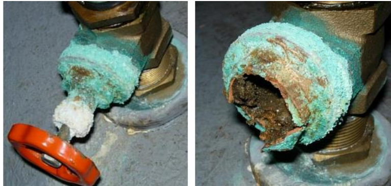
Slika 7: Decinkacijom mjedi uzrokovano je puknuće ventila [19]
