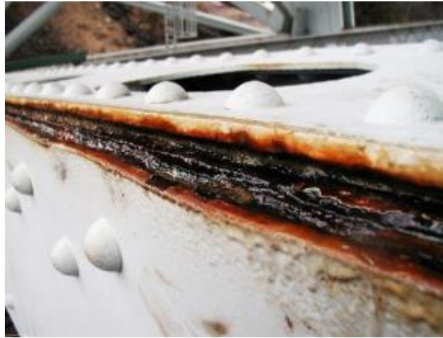
Slika 5: Procijepna korozija konstrukcije mosta [11]
