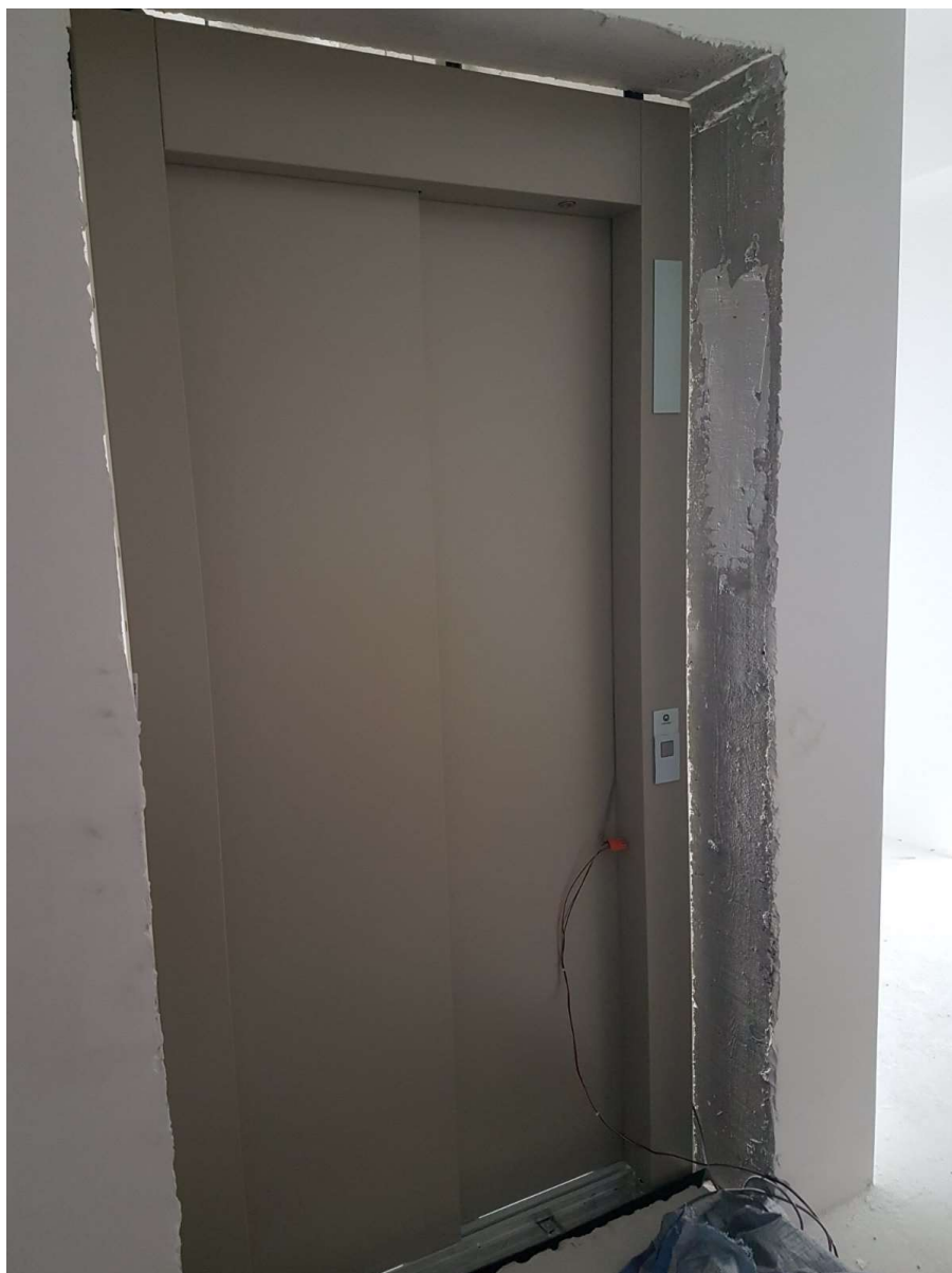
Slika 26. Vrata voznog okna
