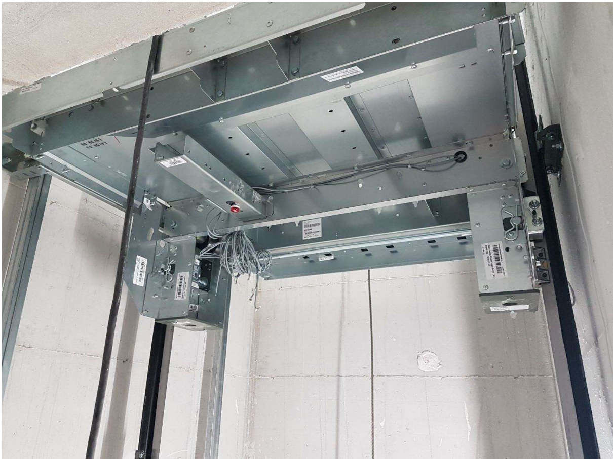
Slika 23. Donja strana poda kabine s kliznim tijelima
