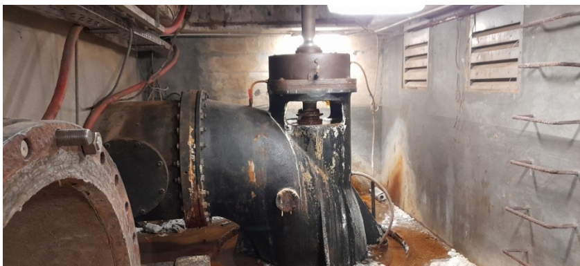
Slika 44. Vratilo pompe i tlačna cijev TE PLomin 2 locirano ispod pumpe [autor]
