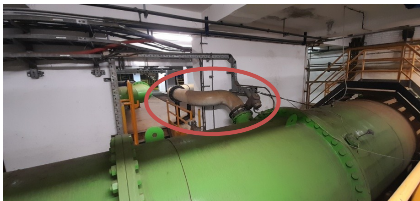
Slika 45. Kondenzatorska cijev i uređaj Taprogge [autor]
