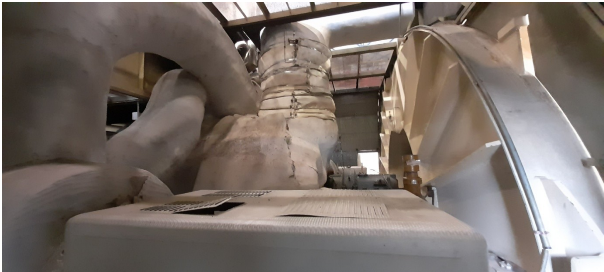
Slika 39. Srednjetačni dio turbine [autor]
