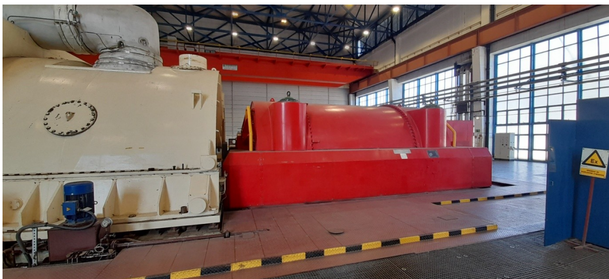
Slika 23. Spoj turbine i elektro-generatora (crveno kućište) [autor]
