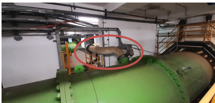
Slika 45. Kondenzatorska cijev i uređaj Taprogge [autor]
