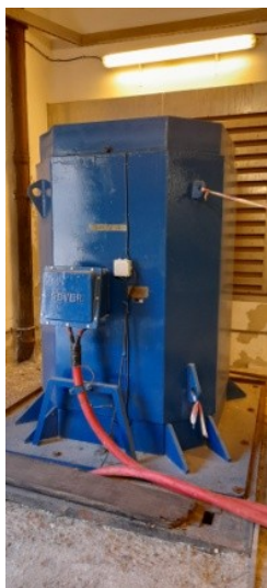
Slika 43. Pumpa TE Plomin 2 u pumpnoj stanici uz more [autor]
