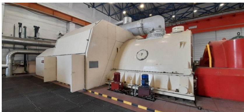
Slika 37. Turbinsko postrojenje izvana [autor]
