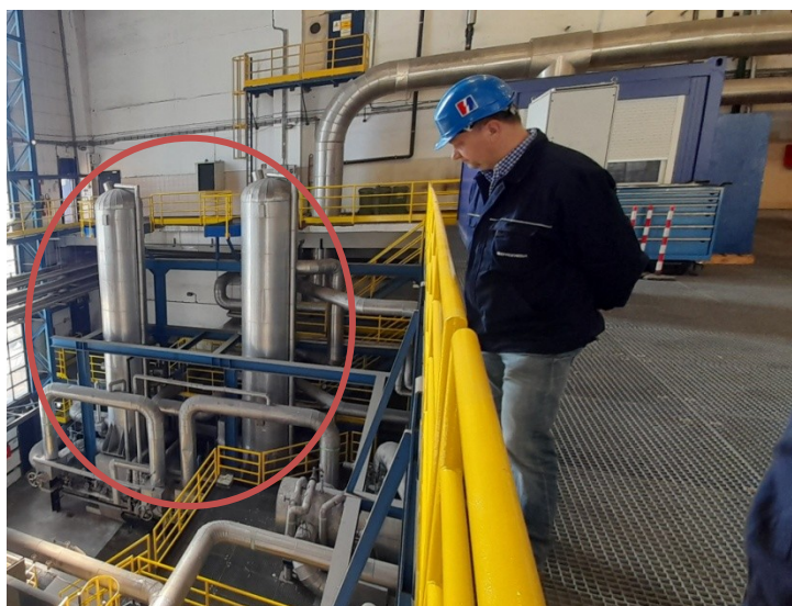
Slika 25. Visokotlačni regenerativni zagrijači napojne vode [autor]
