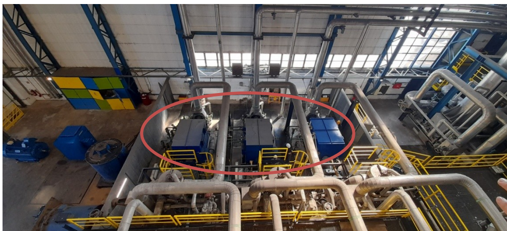
Slika 24. Tri napojne pumpe u elektrani [autor]
