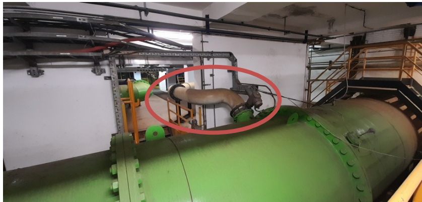
Slika 45. Kondenzatorska cijev i uređaj Taprogge [autor]
