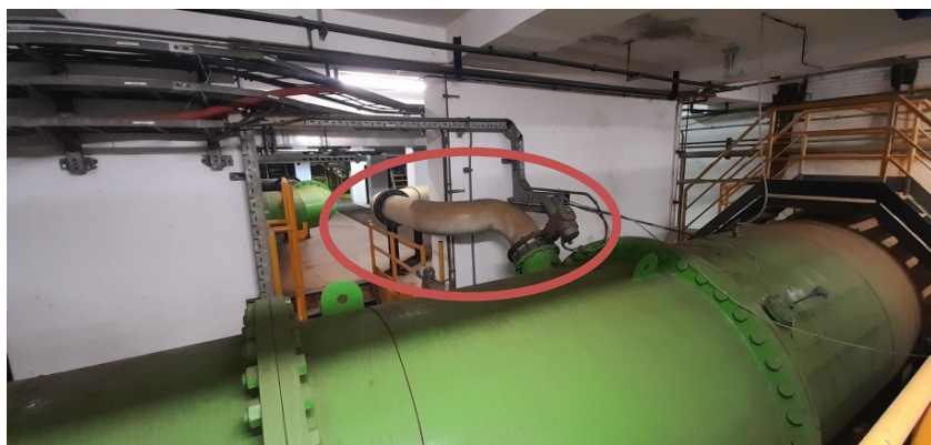
Slika 45. Kondenzatorska cijev i uređaj Taprogge [autor]
