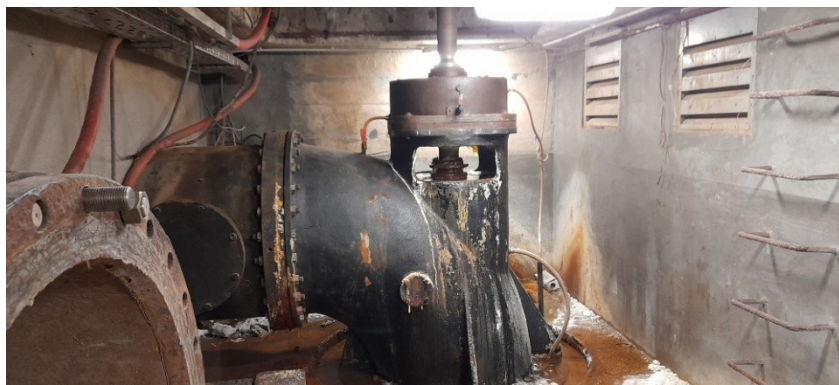
Slika 44. Vratilo pumpe i tlačna cijev TE PLomin 2 locirano ispod pumpe [autor]
