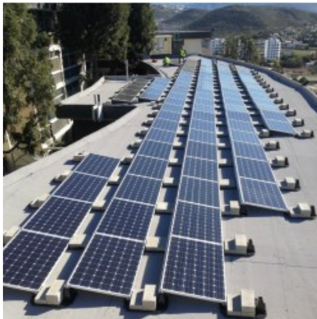
Slika 20. Fotonaponski sustav za ravni krov
