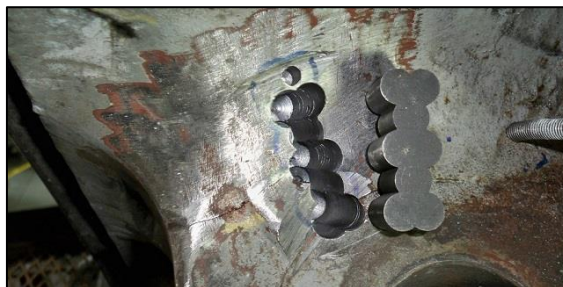
Slika 13. Primjer reparacije bloka motora zamjenskim umetkom.
