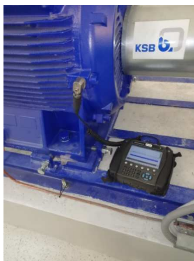
Slika 5.6 Mjerenje vibracija u smjeru H na položaju EM1 CA 1 crpne stanice Sv. Stjepan
