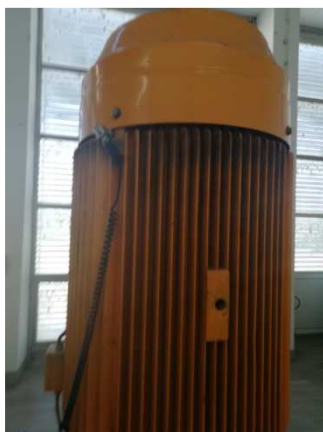
Slika 5.12 Mjerenje vibracija u smjeru H na položaju EM2 CA 2 crpne stanice Gradole
