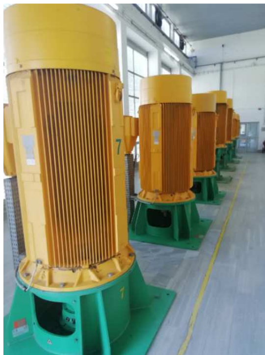
Slika 5.2 Crpna stanica Gradole
