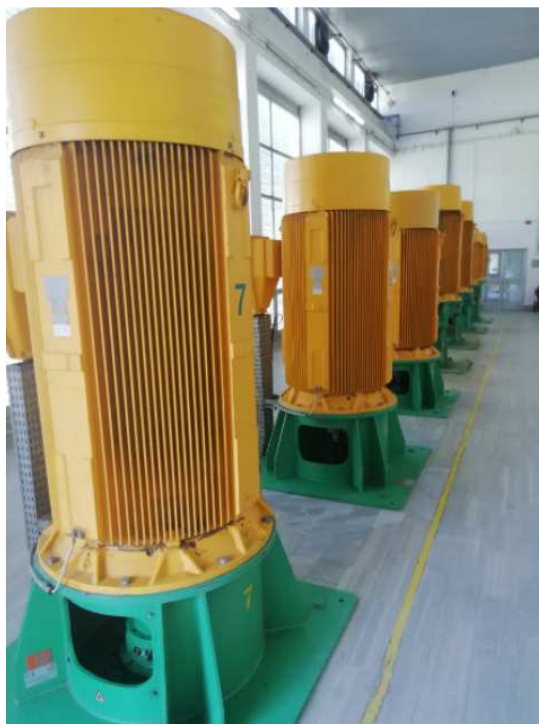
Slika 5.2 Crpna stanica Gradole
