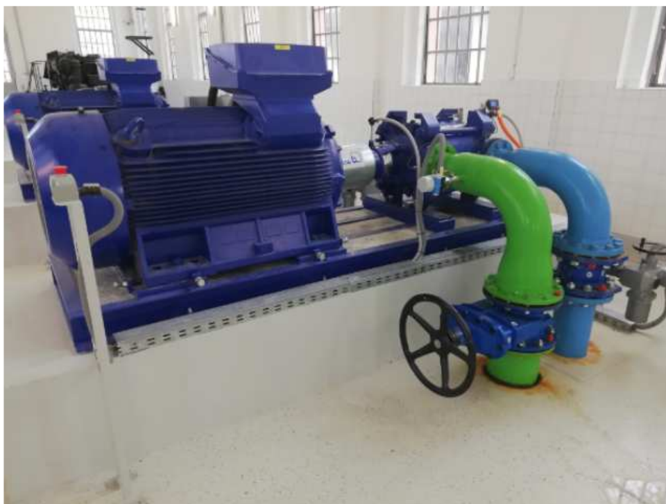
Slika 5.1 Crpni agregat 3 i 4 crpne stanice Sv. Stjepan
