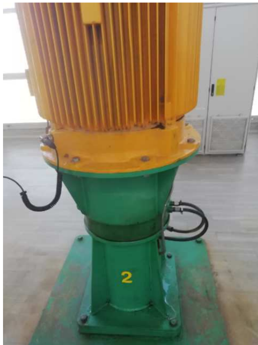
Slika 5.11 Mjerenje vibracija u smjeru H na položaju EM1 CA 2 crpne stanice Gradole
