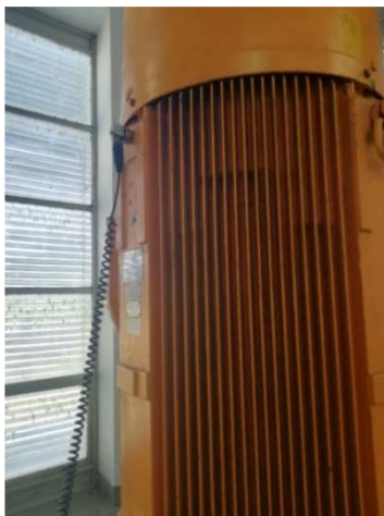
Slika 5.13 Mjerenje vibracija u smjeru V na položaju EM2 CA 7 crpne stanice Gradole
