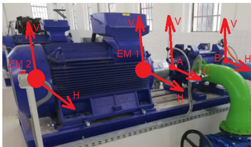
Slika 5.5 Karakteristični položaji i smjerovi mjerenja vibracija CA crpne stanice Sv. Stjepan
