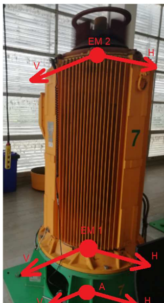
Slika 5.10 Karakteristični položaji i smjerovi mjerenja vibracija CA crpne stanice Gradole
