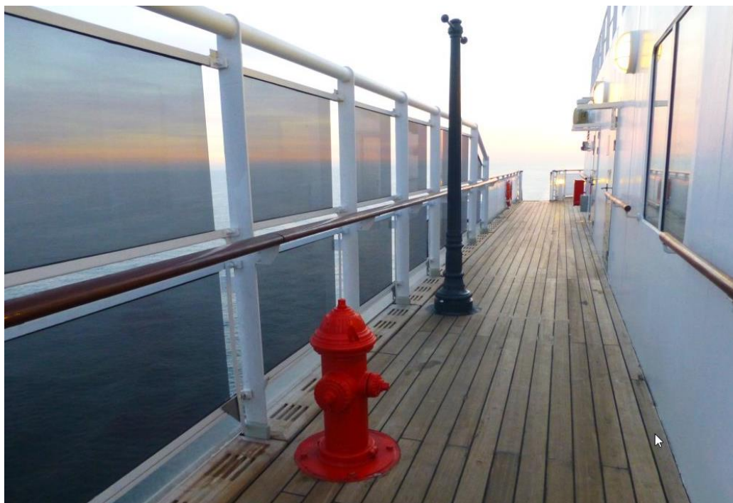
Slika 11. Primjer hidranta na brodu
