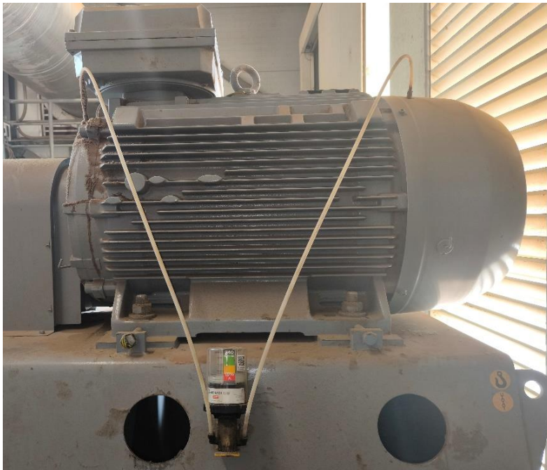
Slika 6.19. Elektromotor 315 kW i automatska mazalica
