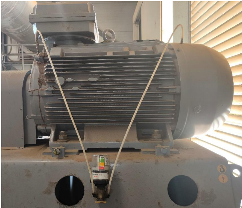
Slika 6.19. Elektromotor 315 kW i automatska mazalica
