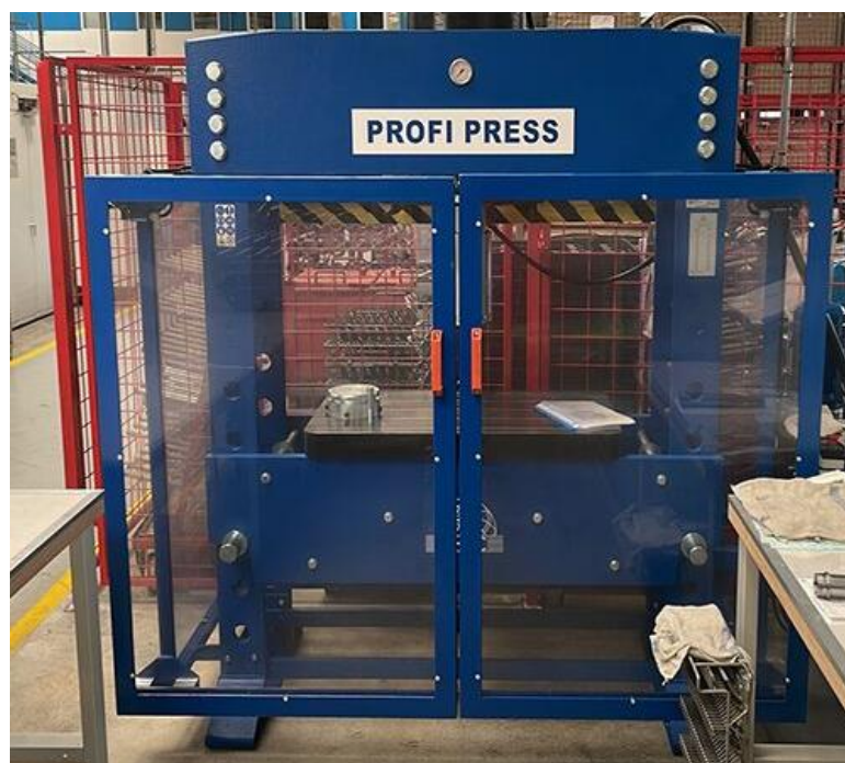
Slika 18. Zaštitna pregrada na preši
