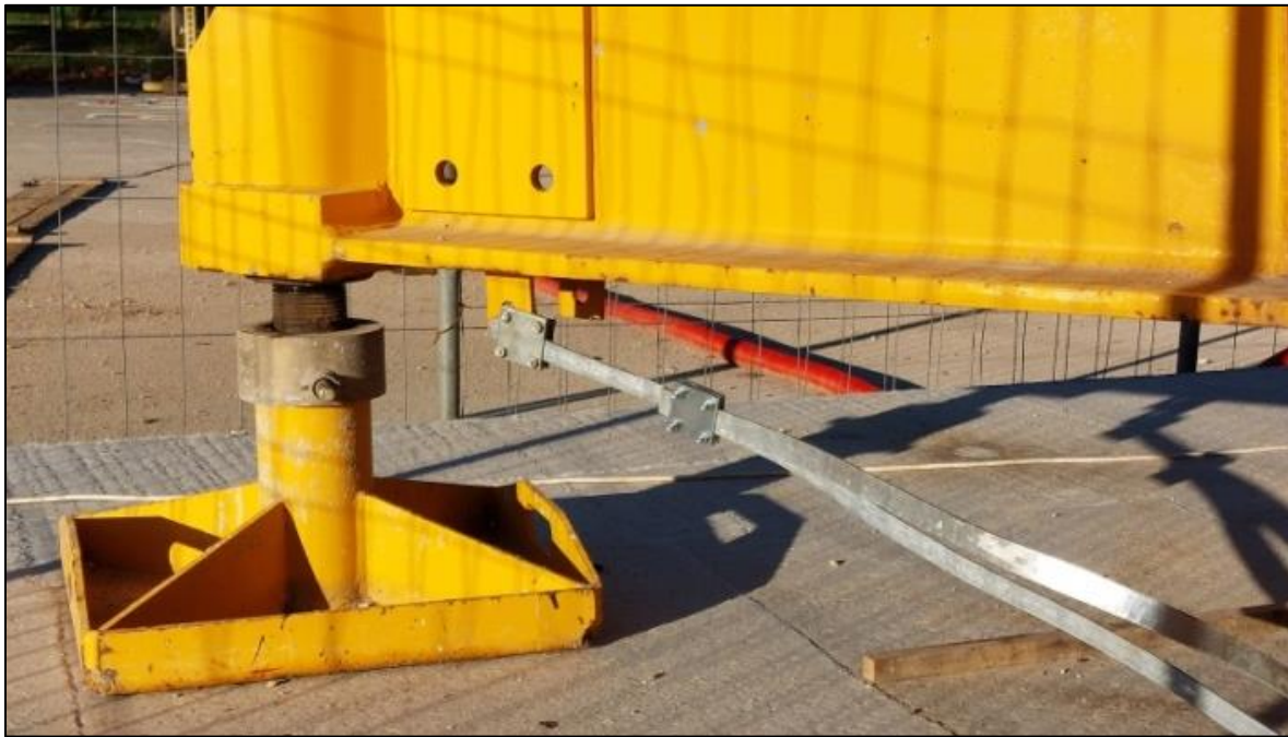
Slika 7: Spoj uzemljivača na metalnu konstrukciju dizalice
